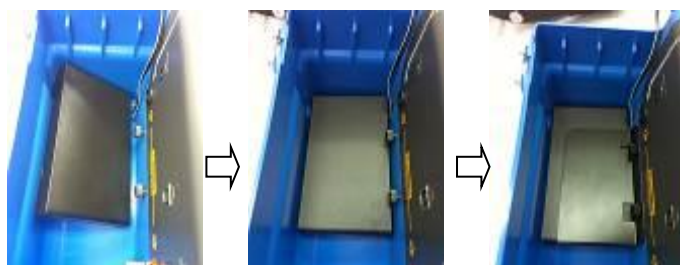
図 5-4. 収納スペース内への電池ボックスの固定
